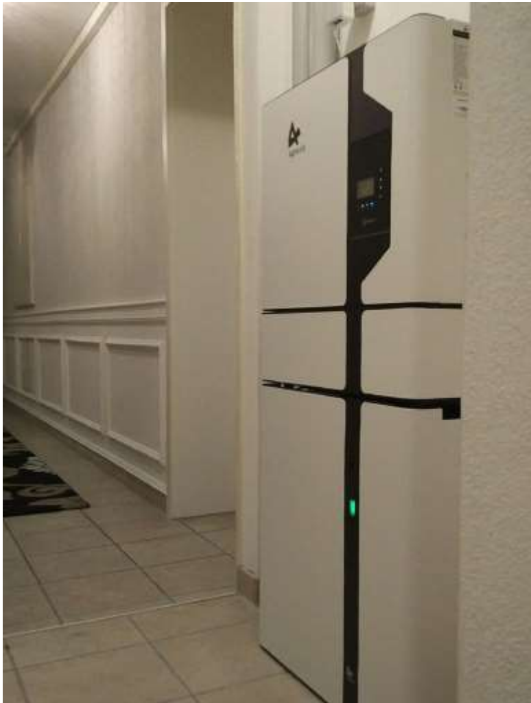
Bild 2: Speichersystem im Keller des EFH von Familie Lisson-Woditsch mit 5,7 kWh Speicherkapazität
